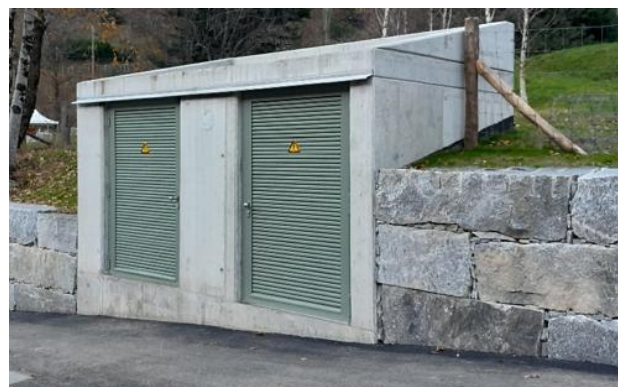
Cabina di trasformazione
