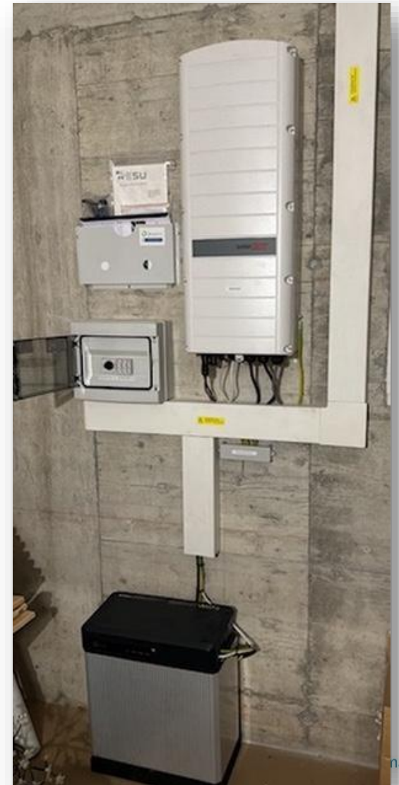
Inverter e batteria
