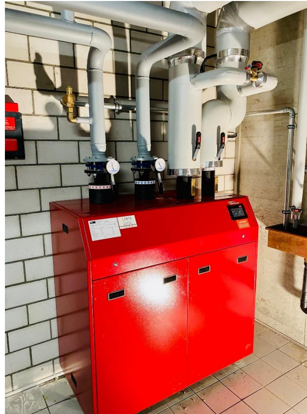
Sottostazione fino a 500 kW
