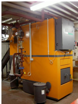
Caldaie per singoli edifici
