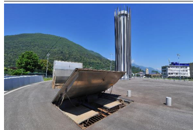
Centrali termiche per interi quartieri
